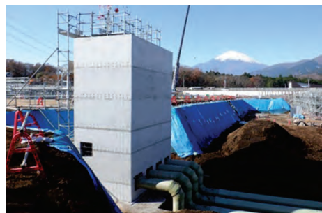
陸上養殖施設地下ピット(PCa)
